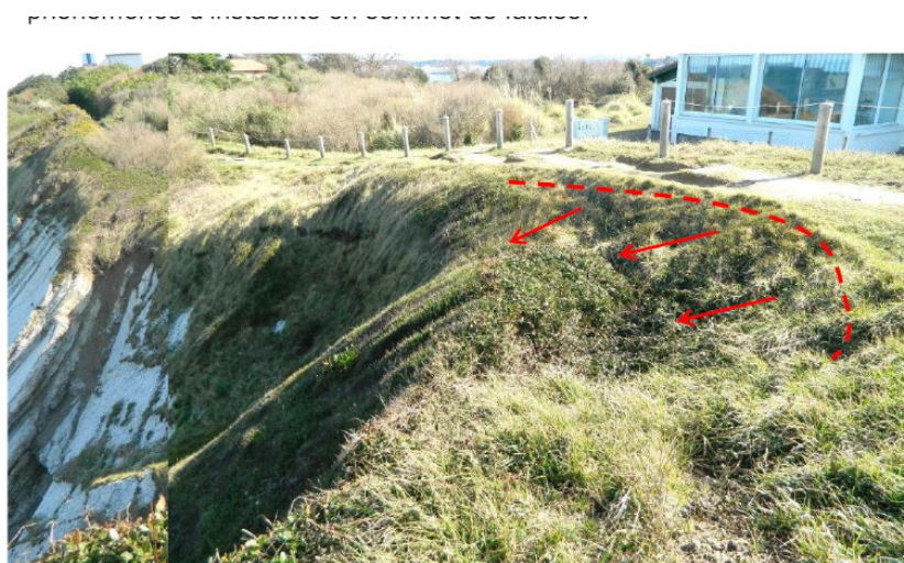
Figure 44 : Affaissement des dalles de flyschs en bordure immédiate du sentier littoral. Les flèches représentent l'orientation des mécanismes d'instabilité prévisibles (Garnier, 2013a).
